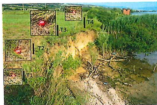
Evaluarea eroziunii malurilor
